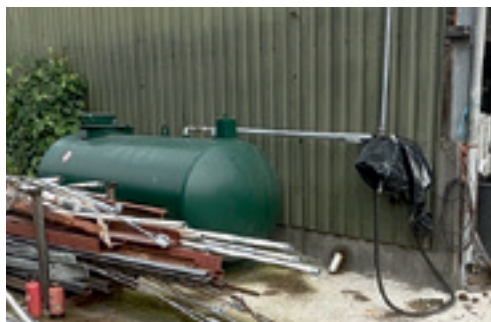
Zorg ervoor dat de tankinstallatie goed bereikbaar blijft voor laden, controleren en afleveren.
